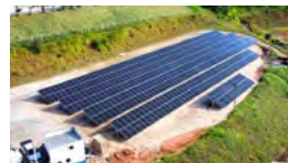
Estação fotovoltaica Armazém de Café e Unidade Dr. João Emygdio
